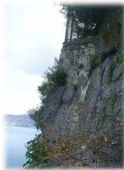
Fig. 7: blocco in parete
