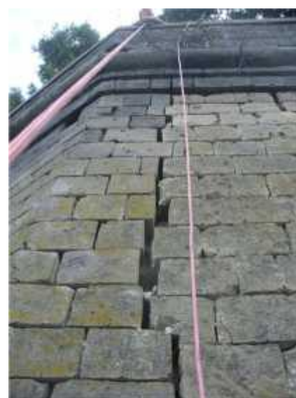
Fig 10. muro di contenimento con evidenti problemi di stabilità
