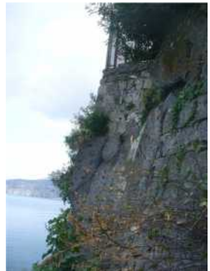
Fig 11. alcuni blocchi di roccia tufaceo in posizione di scivolamento
